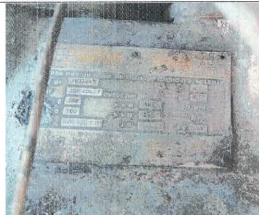
Vista de la placa del motor 2
