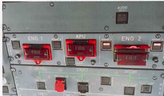
Fig. 1.14.a. Guarda levantada y activación de la esfera extintora del motor No. 2.
