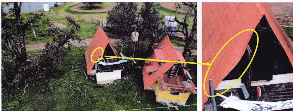
Imagen 2, Daños al techo de una casa aledaña a la pista, se observa la semiala derecha desprendida
