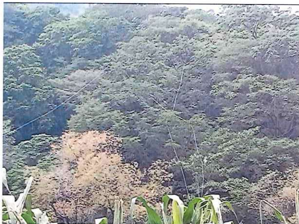
Imagen 6.- Cables sobre las copas de los árboles
