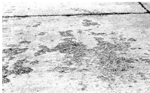
Figura 3.1.23. Descascaramiento y escamaduras
