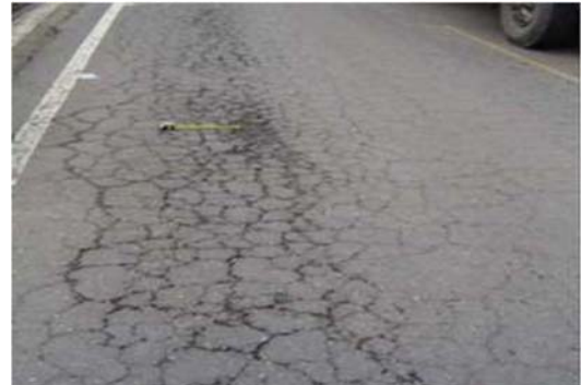
Figura 3.1.8. Agrietamiento piel de cocodrilo
