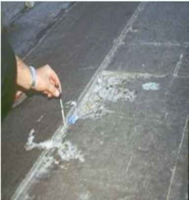
Figura 3.1.21. Deformación por hundimiento
