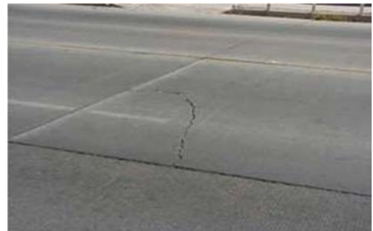
Figura 3.1.16. Grietas de Esquina
