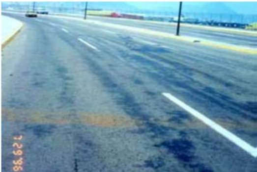
Figura 3.1.12. Exudación de asfalto
