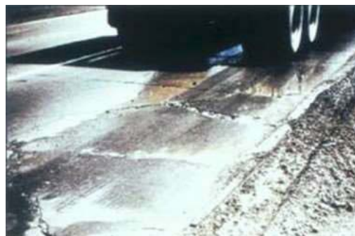
Figura 3.1.22 migración de finos y hundimiento local
