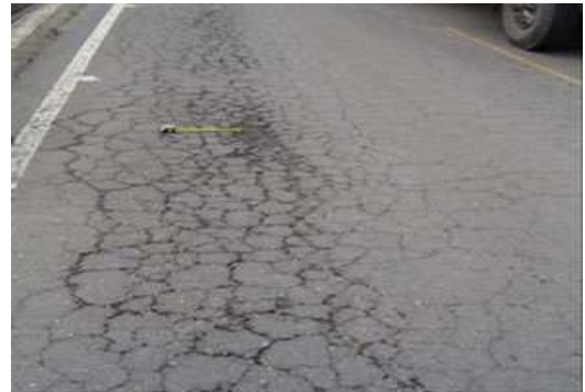
Figura 3.1.8. Agrietamiento piel de cocodrilo
