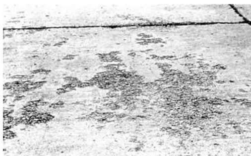
Figura 3.1.23. Descascaramiento y escamaduras
