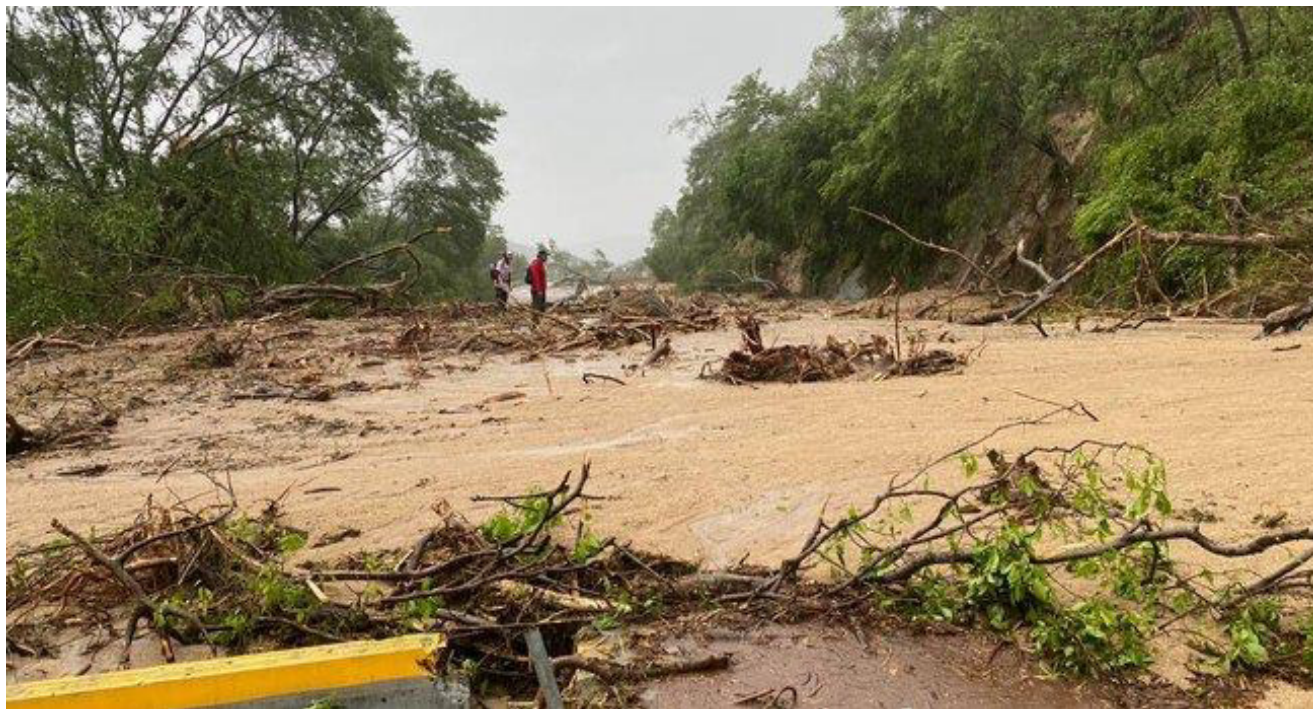
Afectaciones por el huracán "Otis", desbordamiento del Río Papagayo en el kilómetro 71+100 de la carretera libre de peaje Chilpancingo-Acapulco, en Guerrero.
