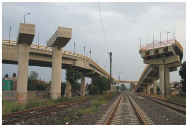
Tren Suburbano, México Tramo: Buenavista - Huehuetoca
