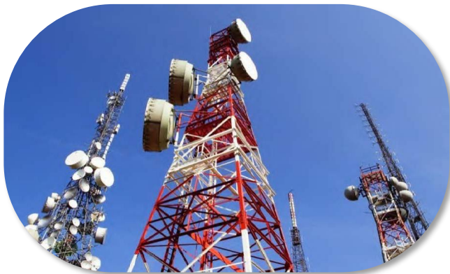
Antenas de Telecomunicaciones
