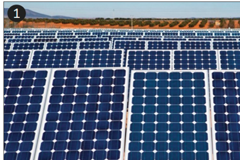
Figura 4.30.- Paneles solares. Colocados en techos de área de servicios.
