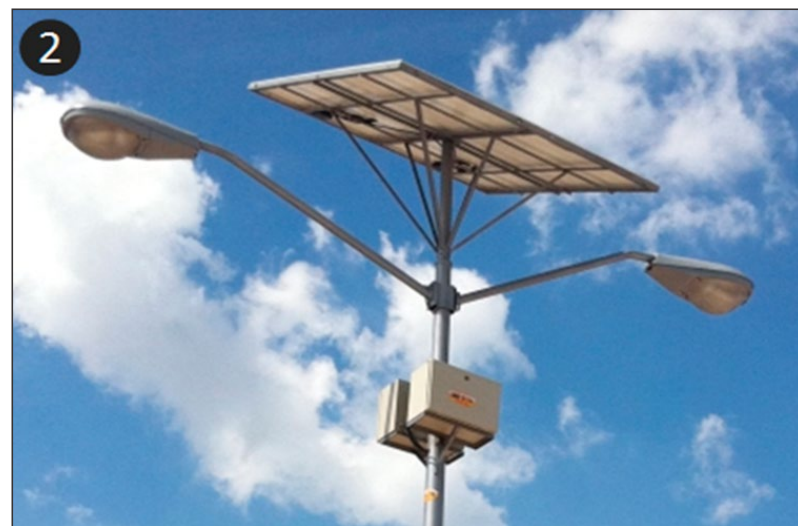
Figura 4.31.- Lámparas para alumbrado exterior en paradores.
