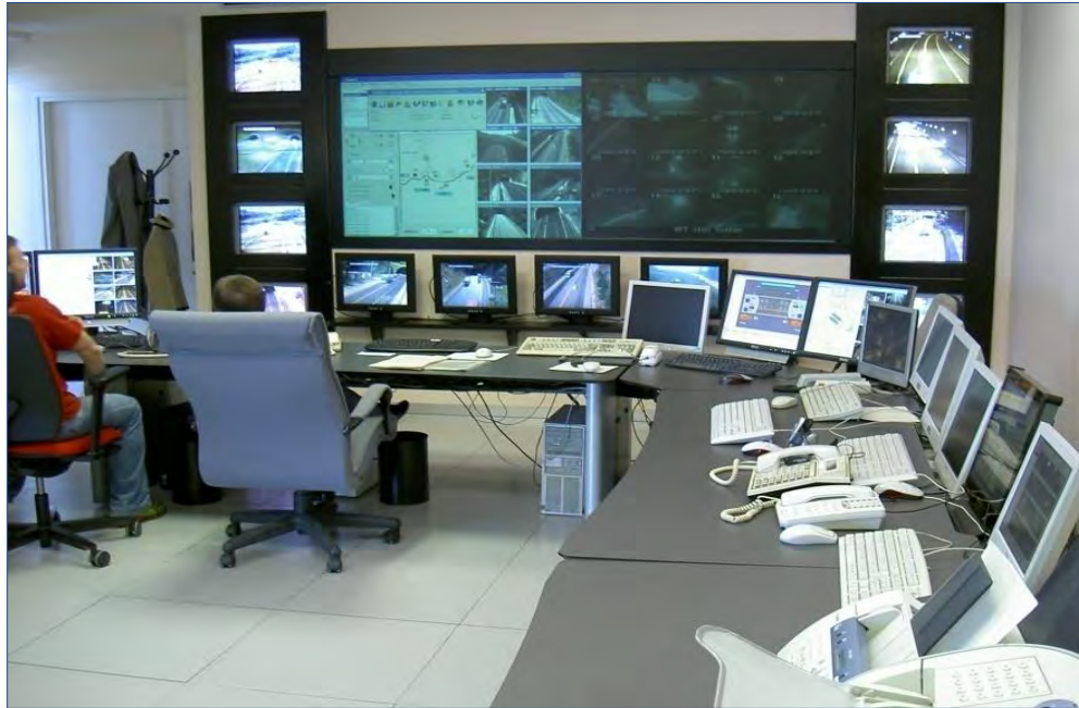
F-10 Central de Monitorización
