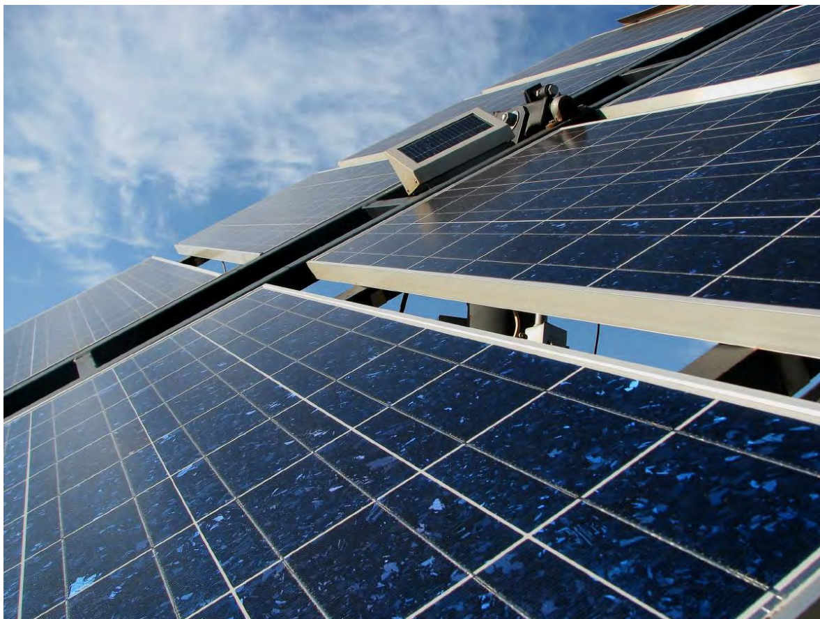
Arreglo de Paneles Solares en Generación Eléctrica Fotovoltaica
