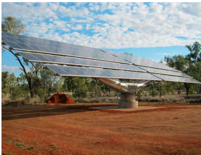
F-05 Estación Fotovoltaica
