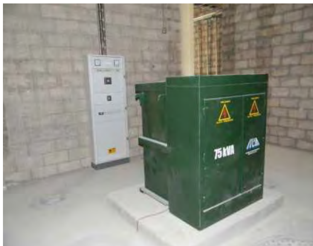
F-04 Tablero de Control para Tensión Media
