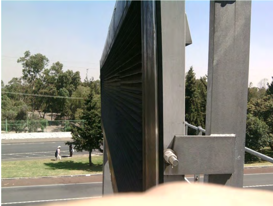
F-27 Detalle de una Señal de Mensaje Cambiable en Formato de Pórtico
