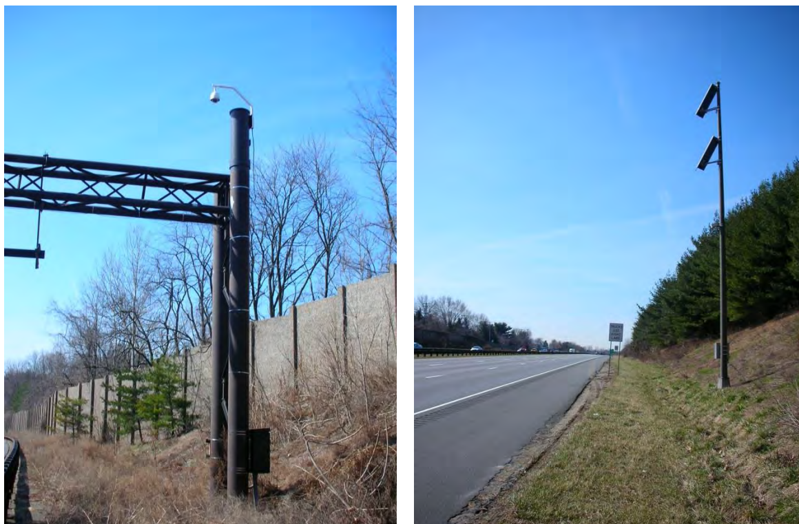
Cámaras de CCTV en Infraestructura Carretera
