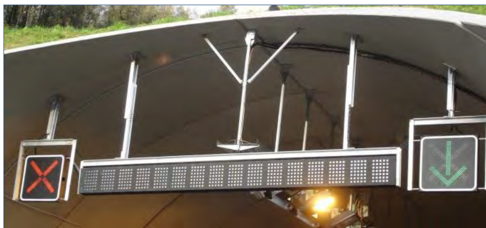
F-58 Subsistemas de señal de mensaje cambiable en túneles
