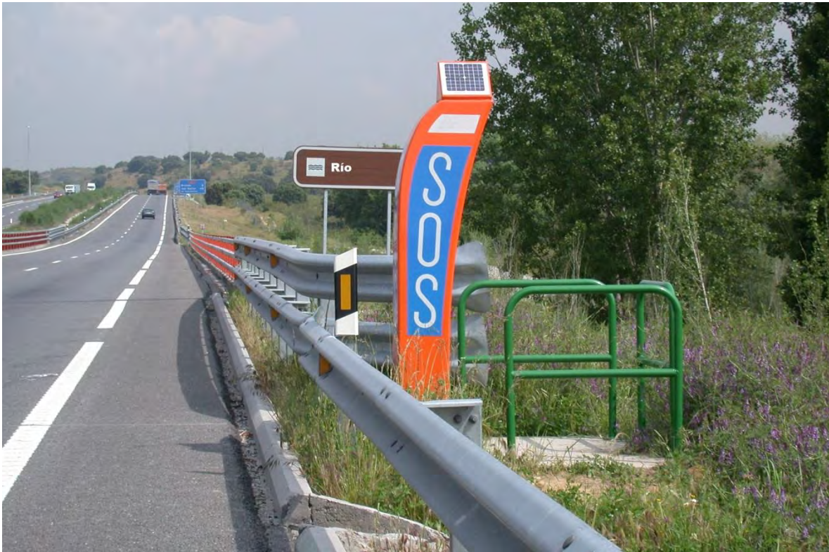
Estación de Asistencia al Usuario – Poste SOS – en Infraestructura Carretera
