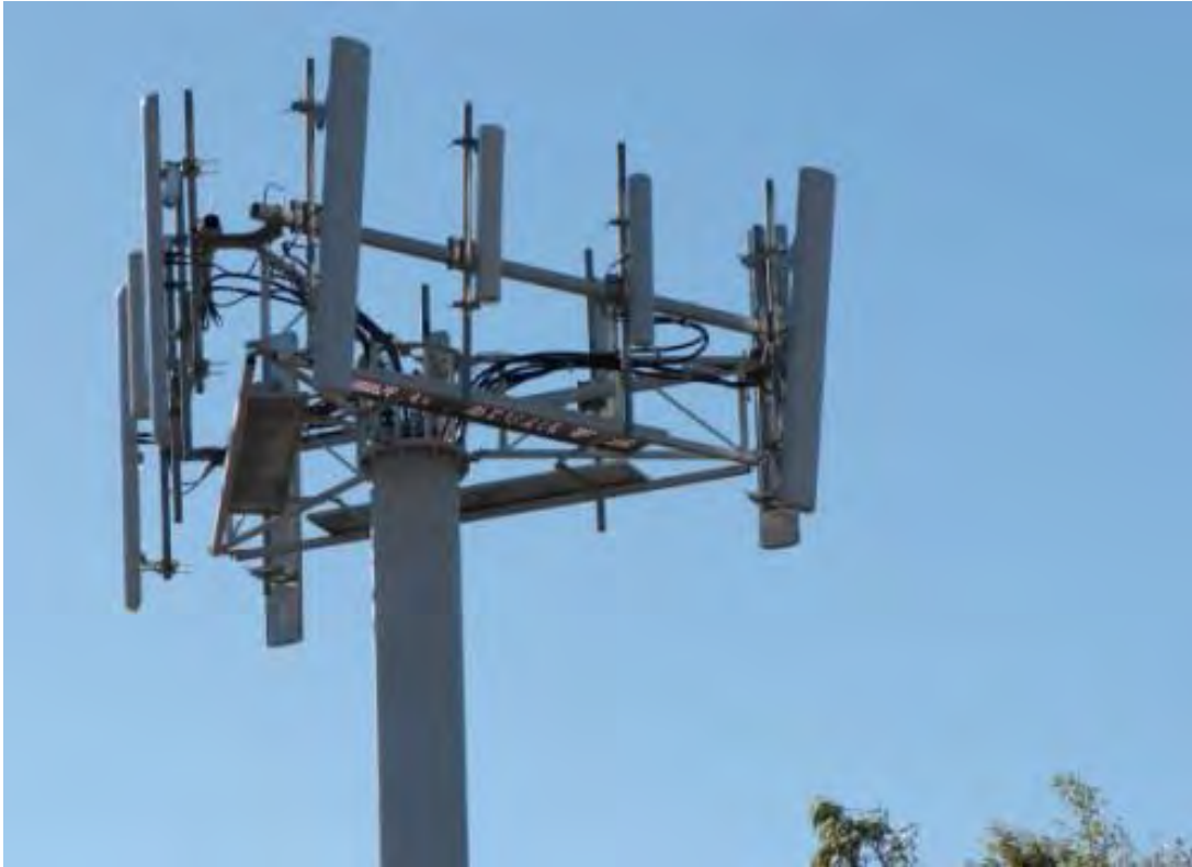
Antenas para Transmisión/Recepción de Radiocomunicación WiMax
