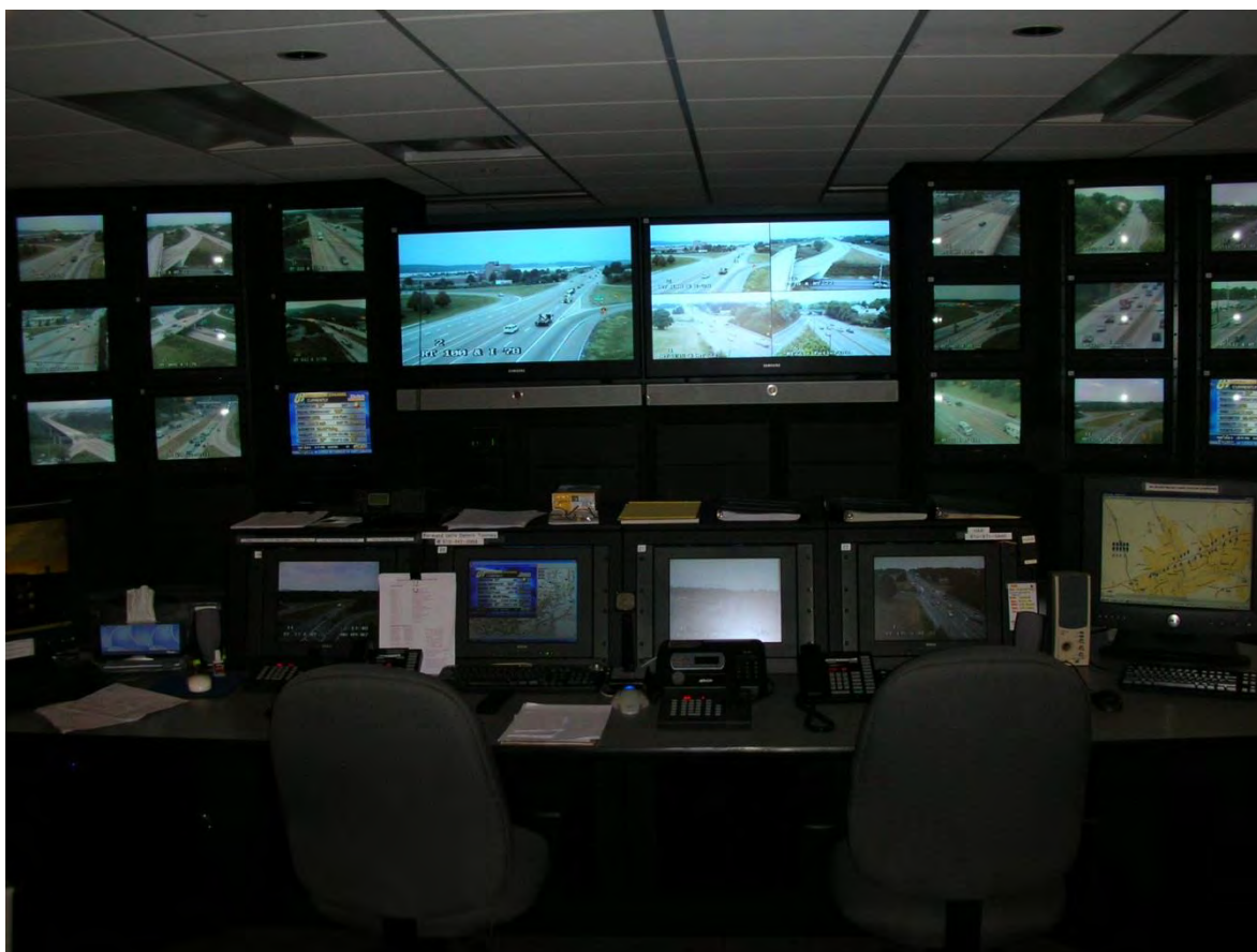
Estación de Operación en Centro de Control
