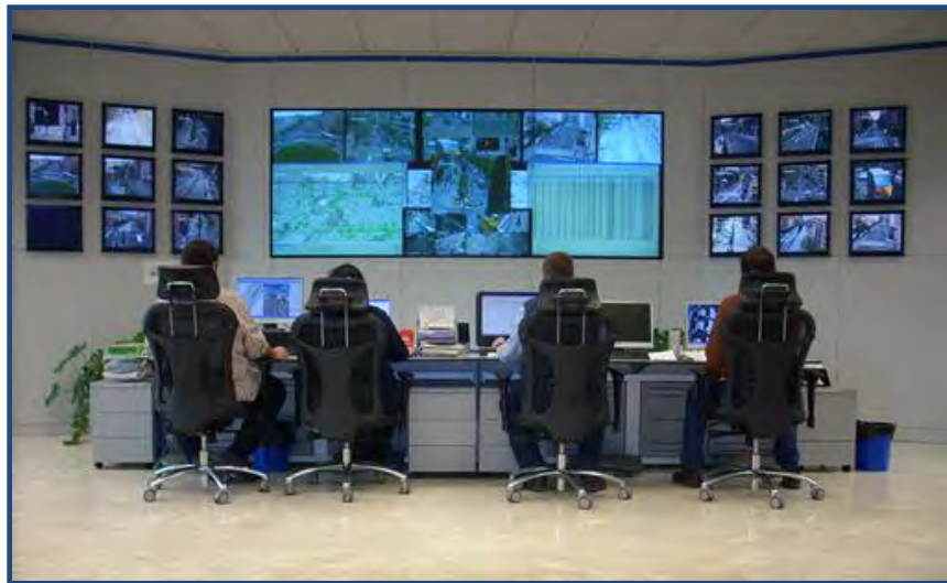
F-02 Interior de un Centro de Control y Operación
